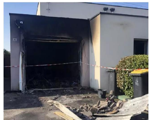
le feu s'est déclaré au niveau du compteur dans le garage de cette maison qui fait partie du parc de vannes golfe habitat. © ouest-france
